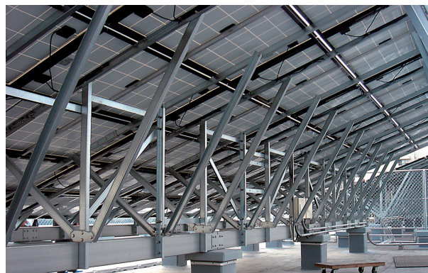
図6 ソーラーパネル架台の写真 Photo of solar panel structure
