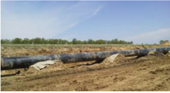
図 18 API グレード X60 鋼管の敷設状況 6) Field construction line of API grade X60 high deformable line pipe
