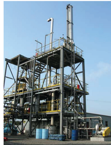
写真2 PDU試験設備外観
