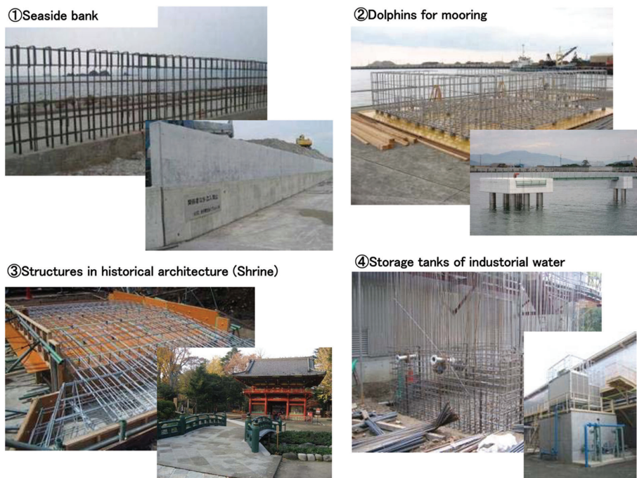
図6 クロム系ステンレス鉄筋NSSD410の適用事例 Applications of Ferritic stainless steel reinforcing bars NSSD410
