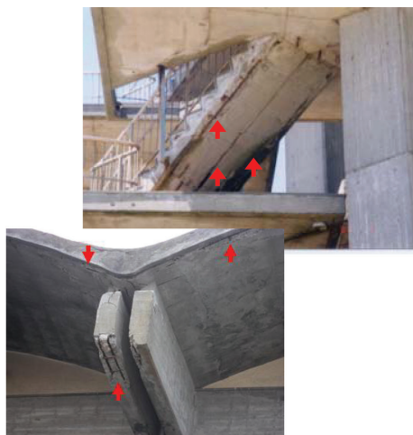
写真10 鉄筋コンクリート構造物の劣化例 Deterioration of reinforced concrete structures
