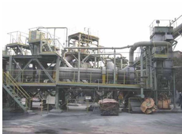
図12 ロータリーキルンの外観写真 Appearance photograph of the rotary kiln
