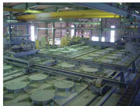
写真1 数多くの原料タンク Raw material tanks
