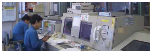
写真3 集中制御室 Intensive control room
