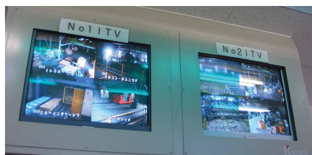
写真4 制御室内の遠隔モニター画面 Monitoring screen in control room
