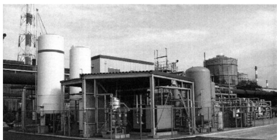
写真1 液体水素製造設備全景 Cover view of the plant
