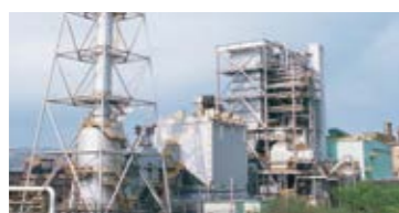
湿式脱硫設備
