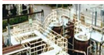
ろ過設備（2次処理）
