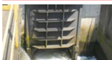
排水遮断ゲート
