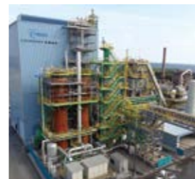
COURSE50試験高炉
