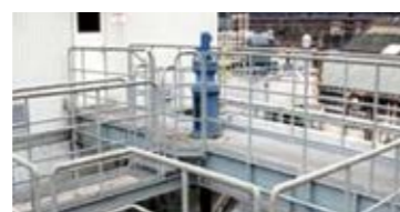
加圧浮上設備
