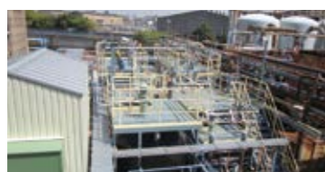
排水凝集沈殿処理設備
