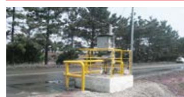
排水自動監視装置
