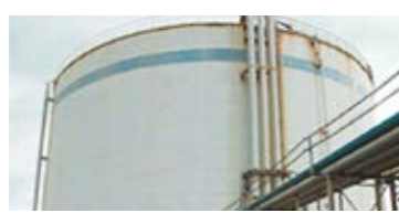
雨水タンク（散水用）
