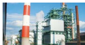
活性コークス式乾式脱硫脱硝設備
