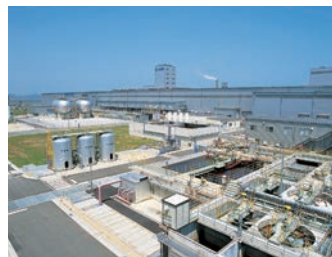
水処理設備（東予製造所）
