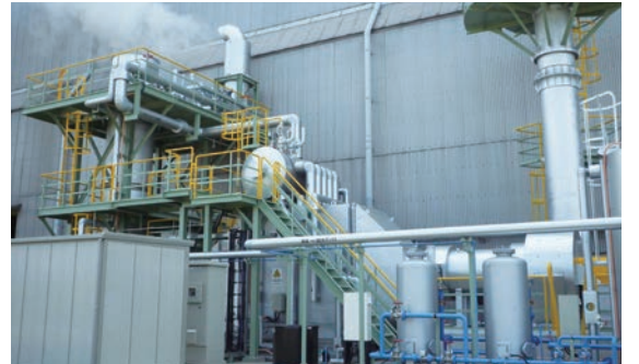
廃熱回収ボイラー
