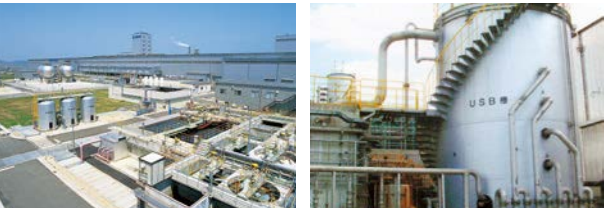
水処理設備(東予製造所) 排水脱窒設備(USB生物処理)(衣浦製造所)
