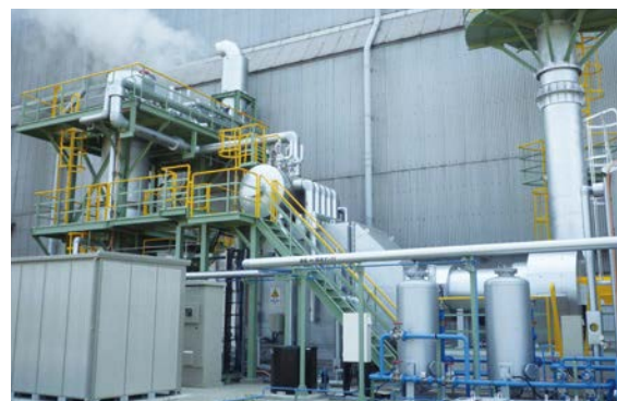
廃熱回収ボイラー
