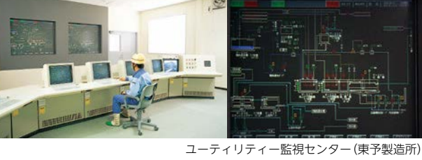
ユーティリティー監視センター(東予製造所)
