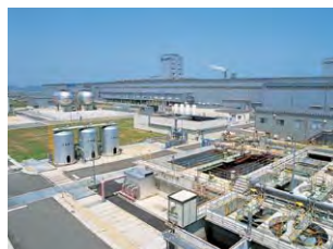
東予製造所「水処理設備」
