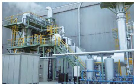
廃熱回収ボイラー
