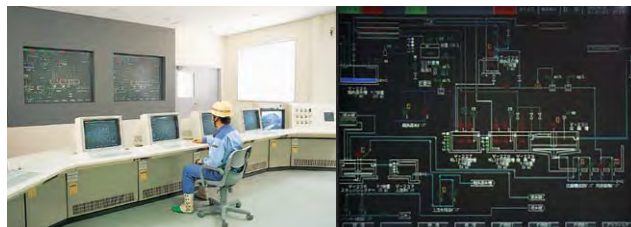
東予製造所「ユーティリティー監視センター」
