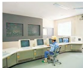
ユーティリティ監視センター
