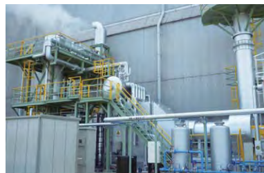
廃熱回収ボイラー
