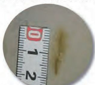
塗膜割れ(錆滲出)／外観検査
