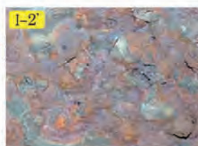
要観察状態を示すさび・被膜(B) 【被膜劣化・こぶ状さび】
