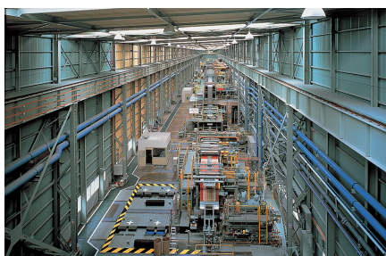
堺製造所：電気亜鉛めっきライン 全景
