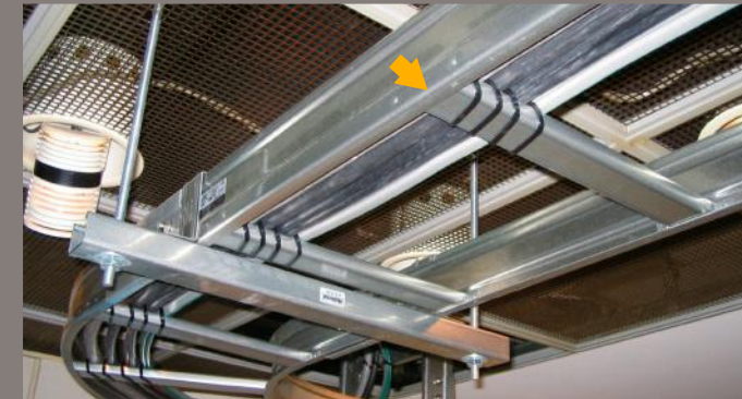
▲ ケーブルラック
