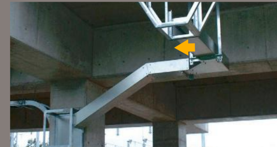
▲ ケーブルダクト
