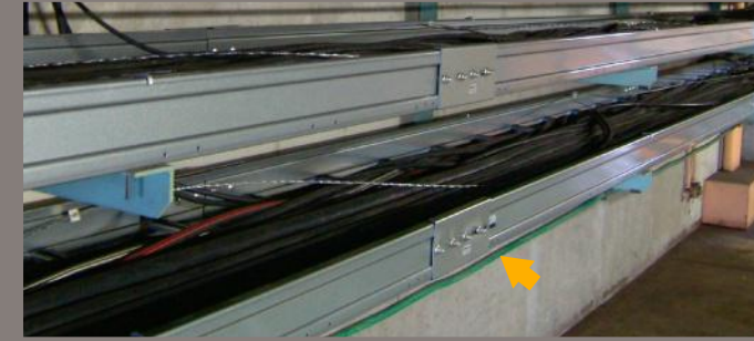
▲ ケーブルラック
