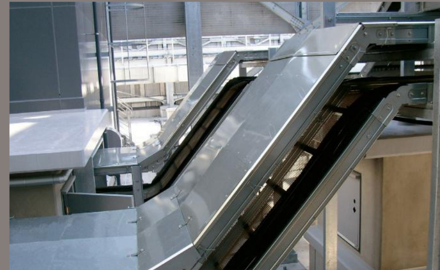
▲ ケーブルラック
