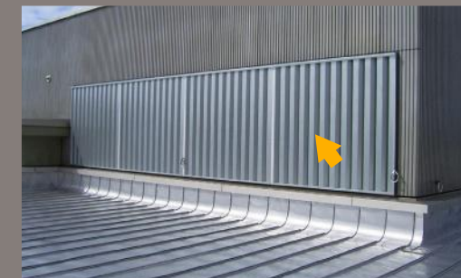
▲ 遮音ルーバー
