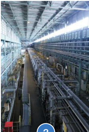
2 焼鈍炉 (横型ラジアントチューブ炉)
