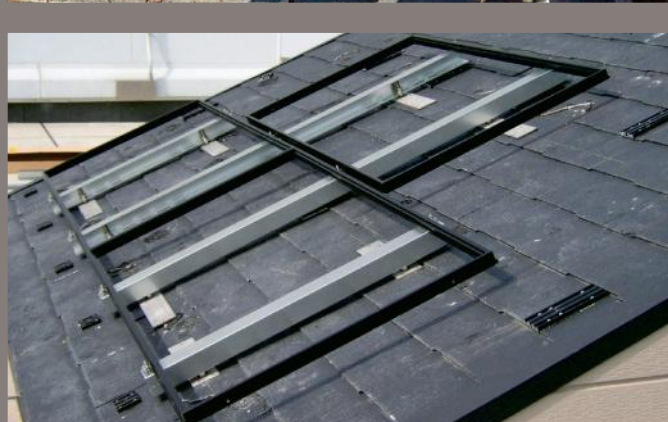
▲ 太陽光発電モジュール架台
