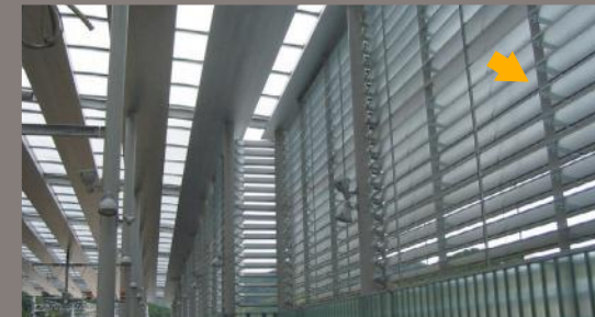
▲ 遮音ルーバー (駅舎)
