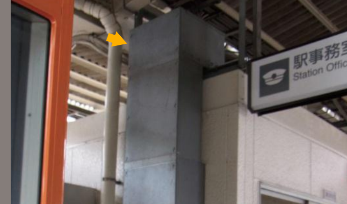
▲ ケーブルラック
