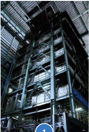
1 焼鈍炉 (縦型直火式還元炉)
