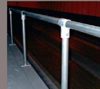
▲ トンネル内ハンドレール
