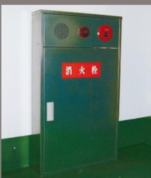
▲ 消火栓ボックス
