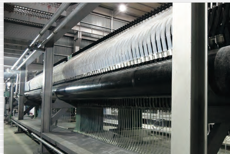
ソーダ電解槽全景
