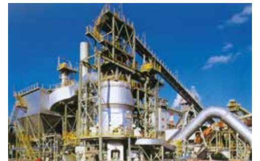
高炉水砕スラグ粉砕設備
