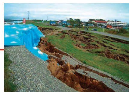
堤防の地震被害例（2004十勝沖地震） 土木研究所HPより引用
