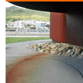
流れさびによる汚れ
