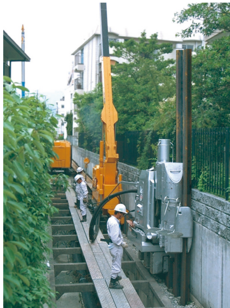
ゼロクリアランス工法による狭隘地での下水道築造工事
