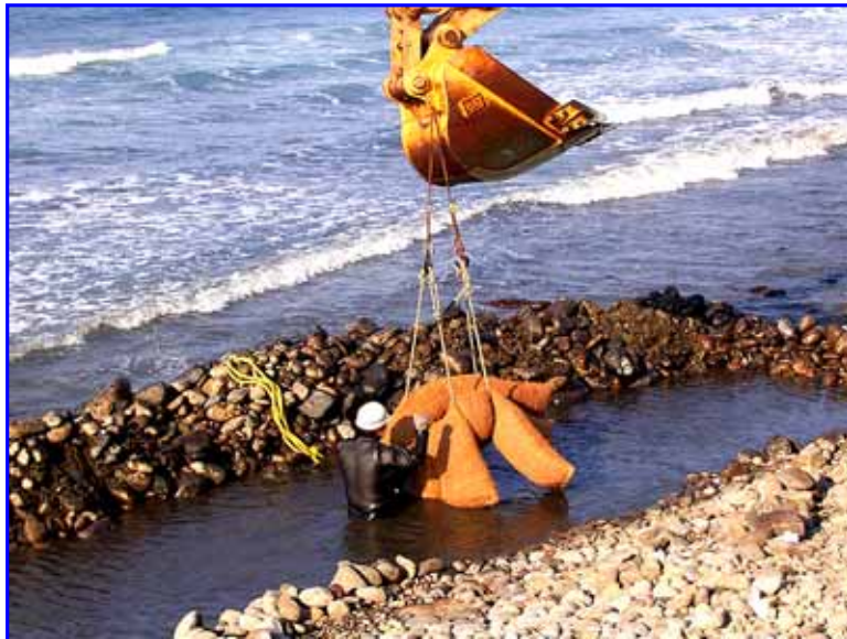
写真1. 鉄鋼スラグと腐植物質からなる施肥ユニットの設置工事状況
