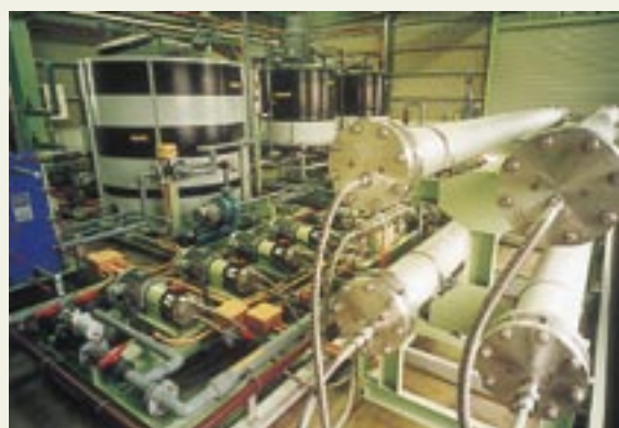
圧力透析方式酸回収設備（住友金属直江津）
