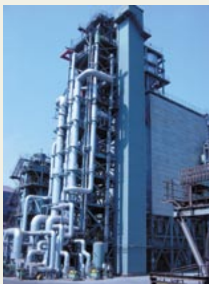
活性コークスによる焼結工場排ガス除じん設備（鹿島）
