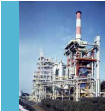
コークス乾式消火設備(CDQ)
