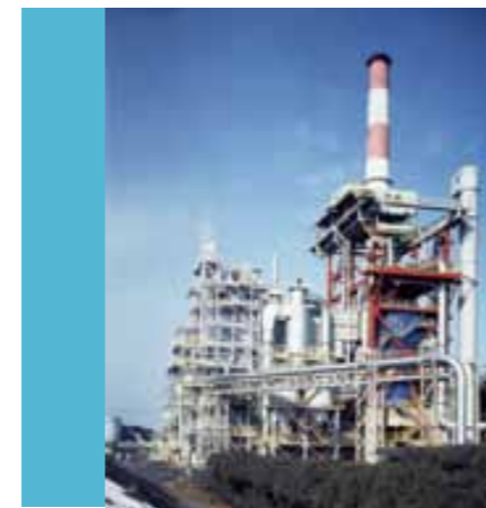
コークス乾式消火設備(CDQ)
