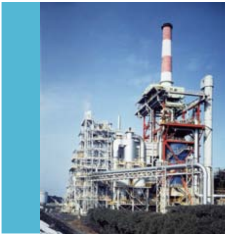
コークス乾式消火設備(CDQ)
