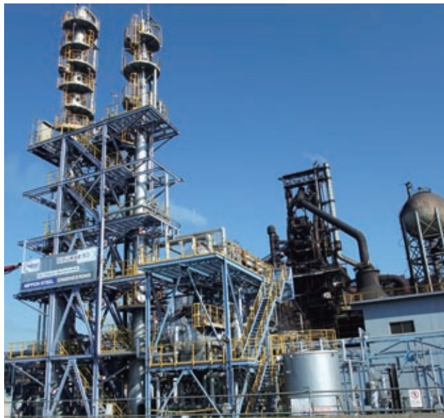
君津製鉄所構内のCO 2 分離回収実証プラント
