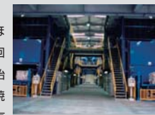
プラスチック事前処理設備
