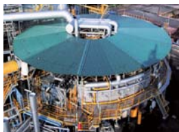
ダストリサイクル還元鉄供給設備
