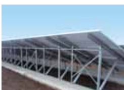
太陽光発電の架台
