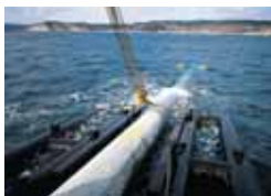
海底にラインパイプとして敷設されるX120
