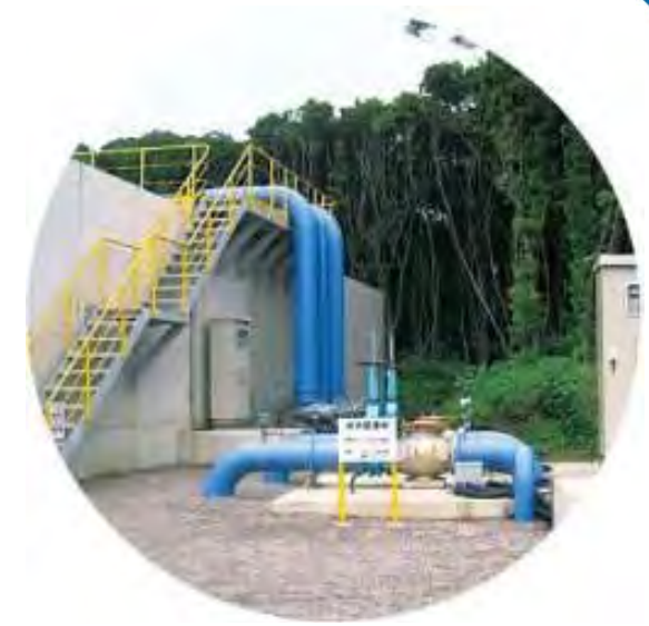
緊急排水 遮断設備
