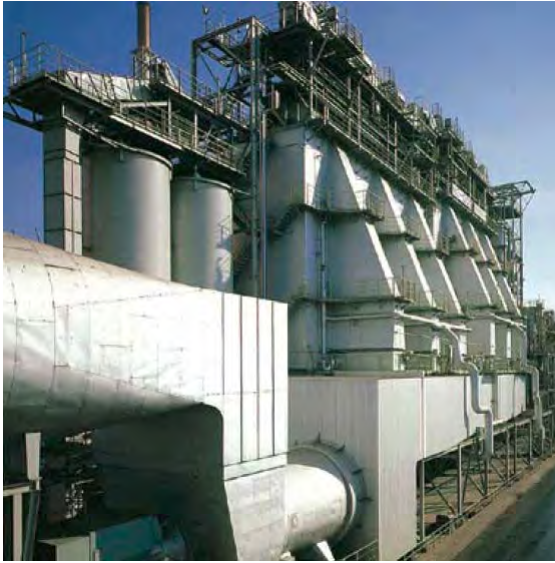
乾式脱硫脱硝 設備
