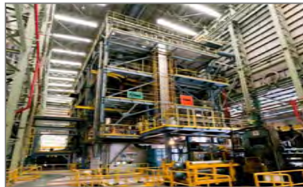
第2溶融亜鉛めっきライン（今回の改造対象設備）
