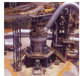
高炉スラグ微粉末製造設備
