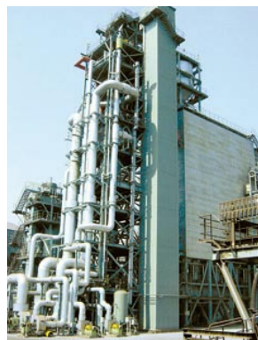
活性コークス式排ガス処理設備(鹿島)
