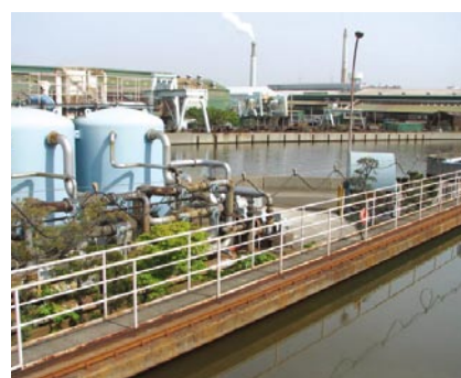
排水処理設備(特殊管)
