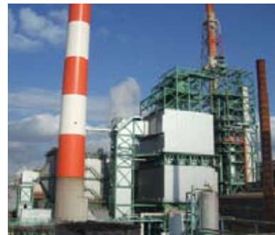
活性コークス式脱硫脱硝設備(和歌山)
