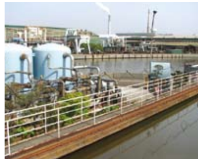
排水処理設備(特殊管)
