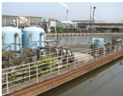
排水処理設備(特殊管)
