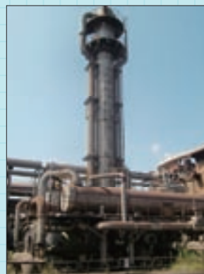
カリーナサイクル発電設備
