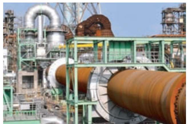
増設RC資源循環炉(鹿島)
