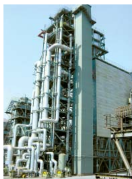
排ガス処理設備(鹿島)
