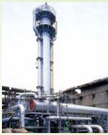
転炉中低温排熱回収設備 (カリナサイクル発電)
