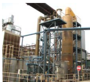
ガス洗浄処理設備(特殊管)
