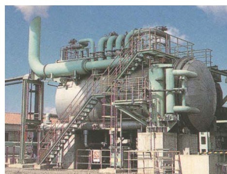
加圧式エージング設備（和歌山）
