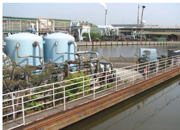
廃水処理設備 (特殊管)
