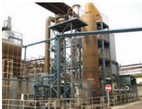
ガス洗浄処理設備(特殊管) 製管工場での酸洗処理時に発生 する排出ガスを中和し、触媒反応 により脱硝処理します。
