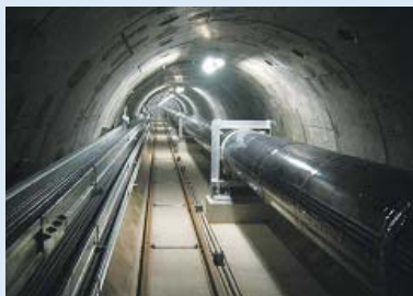
海底トンネル内に設置された直線状LNG配管
