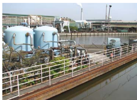
廃水処理設備（特殊管）
