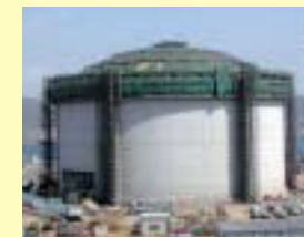
LNG大型タンク
