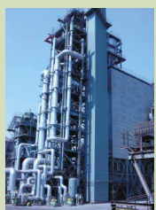
焼結工場排ガス処理設備（鹿島）
