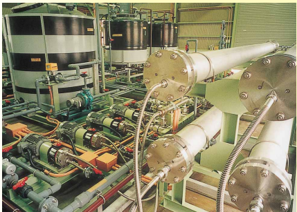
圧力透析方式酸回収設備 ((株)住友金属直江津)
