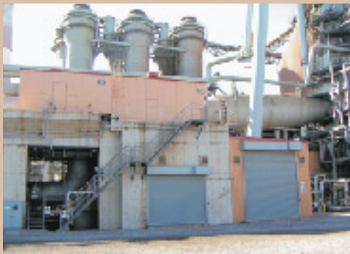
鹿島第1号 高炉TRT
