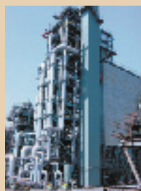
焼結工場排ガス処理設備(鹿島)
