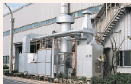
VOC 除去装置 （製鋼所）
