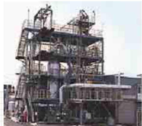
■ 高温ガス化溶融炉実証プラント（鹿島）
