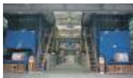
廃プラスチック処理設備
