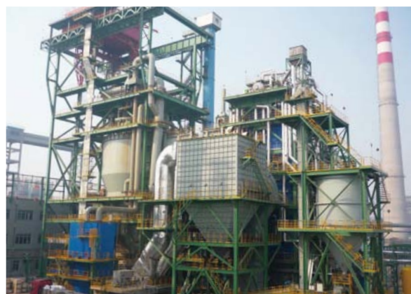
中国 首鋼京唐鋼鉄の大型CDQ
