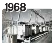
変電所のトランス
