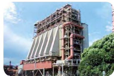
排ガス処理装置(大分製鉄所)
