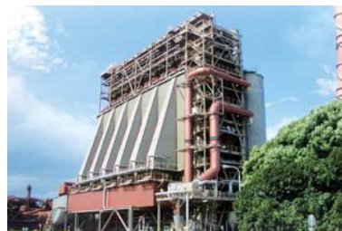
排ガス処理装置(大分製鉄所)
