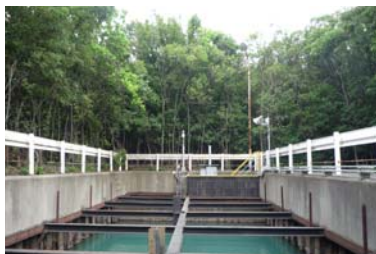
緊急排水遮断設備(堺製鉄所)
