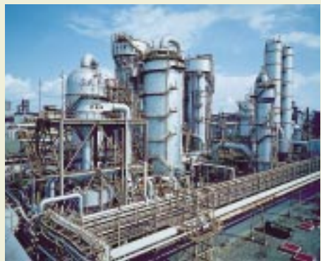
●コークス炉ガス脱硫設備
