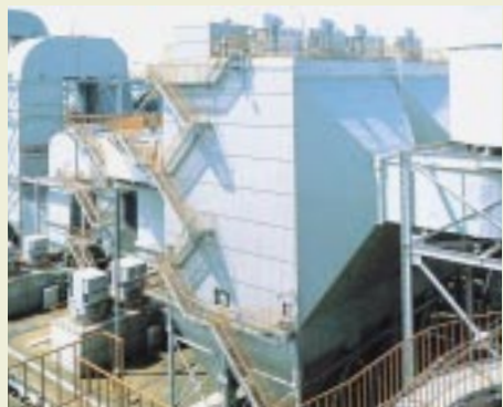
●焼結機排ガス処理設備
