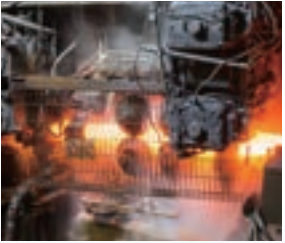
6 小径溶接鋼管設備 Small Welded Pipe Mill
