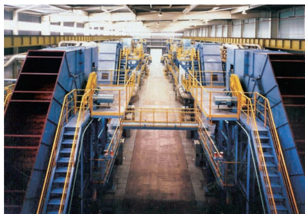
君津製鉄所のプラスチックリサイクル設備
