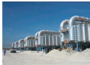
プラント設備
