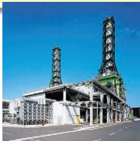
天然ガス発電所
