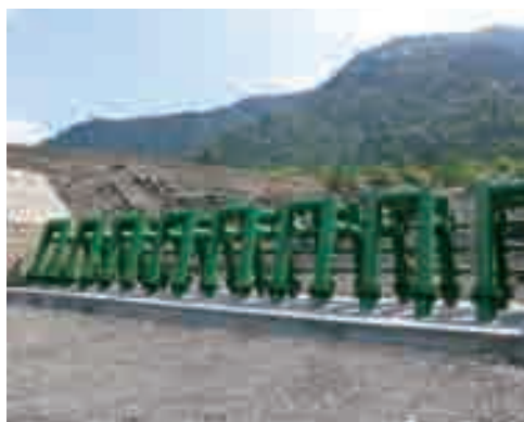
台湾に設置された「鋼製スリット」
